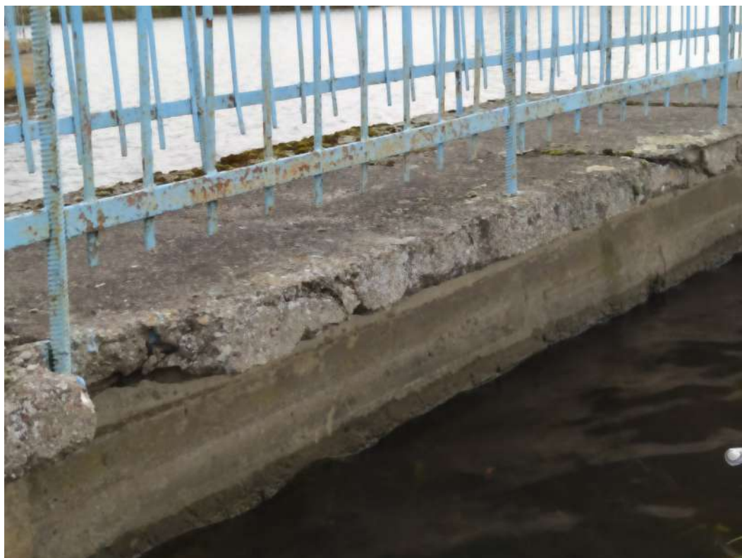
16 pav. Tiltelio danga sutrūkusi, kraštuose nutrupėjęs betonas.
