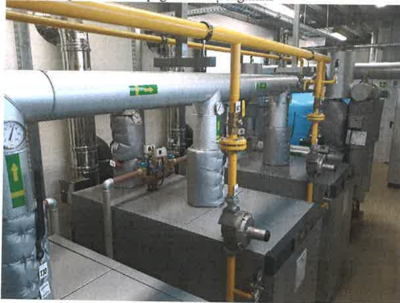
Naujai įrengta katilinė su pagalbinais įrenginiais
